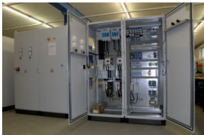
■ Technologický rozváděč – vývoz Německo
